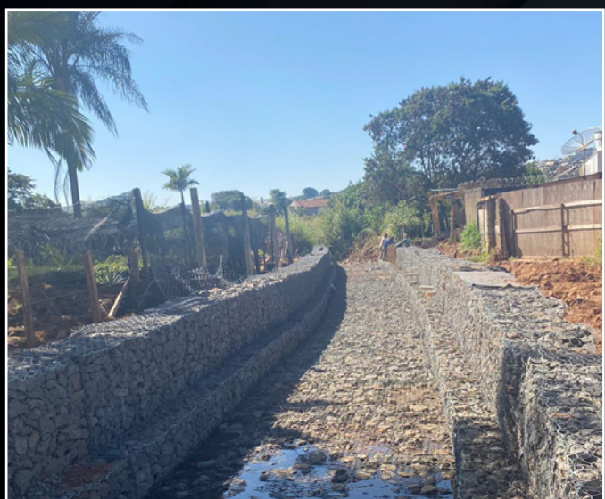
Canalização de córrego em gabião, localizado no município de Passos, MG.
