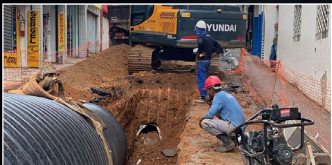
Drenagem em tubo PEAD no município de Pará de Minas, MG.
